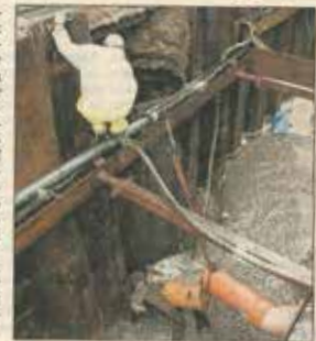
Aus dem Abwasserrohr lief das Wasser in die Baugrube und unterspülte die Straße. Der Verkehr musste umgeleitet werden. Foto: MAXWAT
